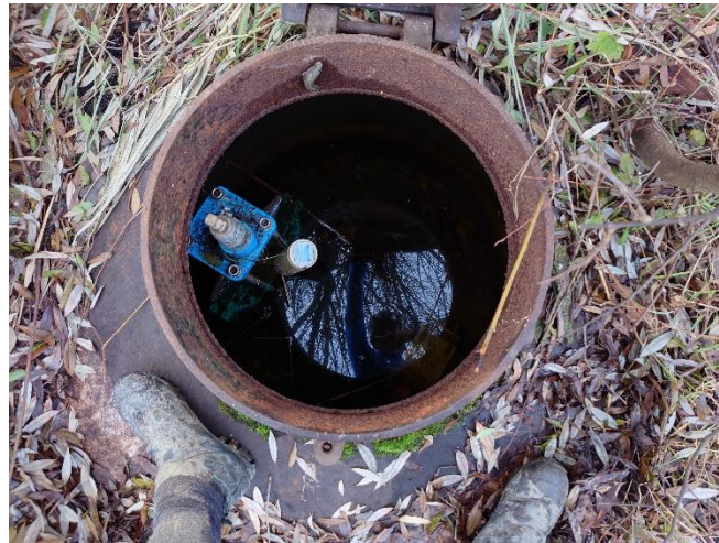
Schieberschacht der Tiefenwasserableitung
